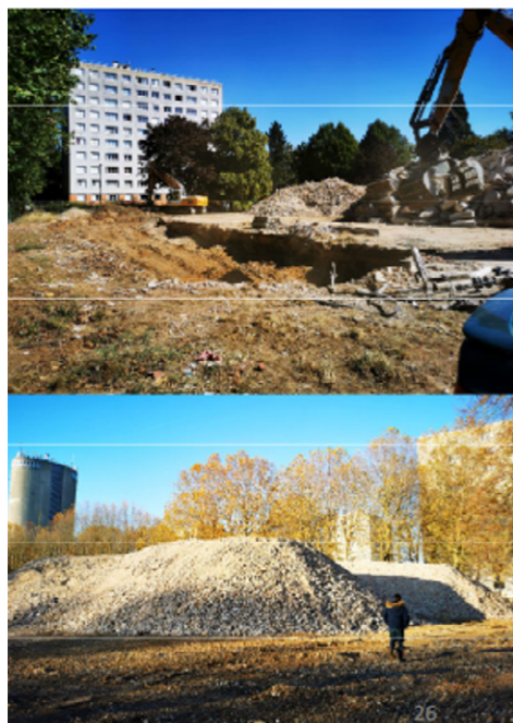
Photos du chantier de démolition de l'ex-pouponnière et du parc Joséphine Baker :
